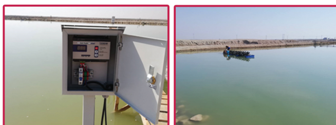
شکل ۶- هواده (سمت راست) و غذاپاش (سمت چپ) اتوماتیک نصب شده در استخر پرورش میگو
